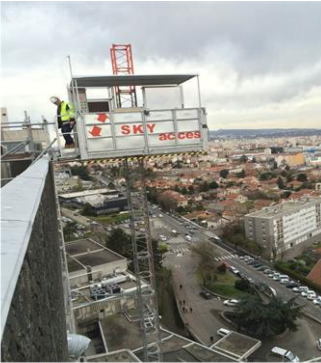
Lift avec accès jusqu'en toiture
